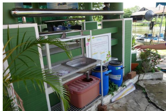
写真30. 河川敷に設置された浄水装置
